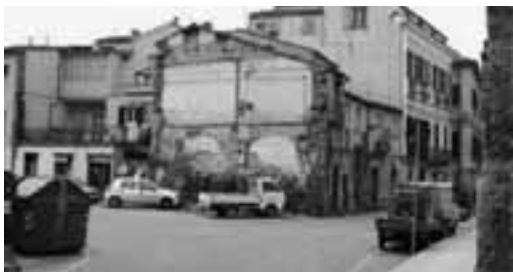
Foto III- Attorno al Teatro romano. Casa Narcisi-Di Raimondo, scampata all'incendio normanno, è uno dei più antichi edifici di Teramo. Ora è lasciata all'incuria e al degrado.
