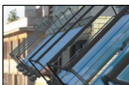
Fig.4 Fotovoltaico integrato in una facciata
