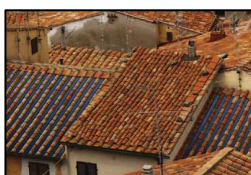
Fig.3 Fotovoltaico integrato in una copertura con cippi
