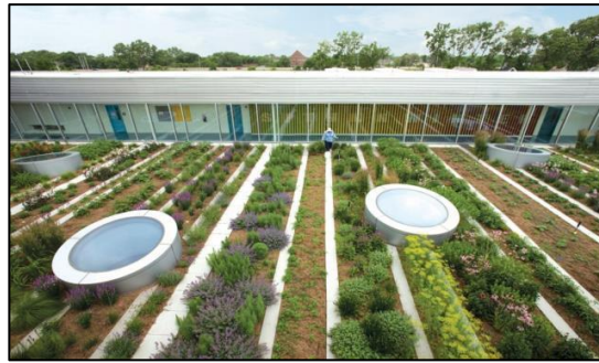
Fig. 4 Esempio di tetto giardino
